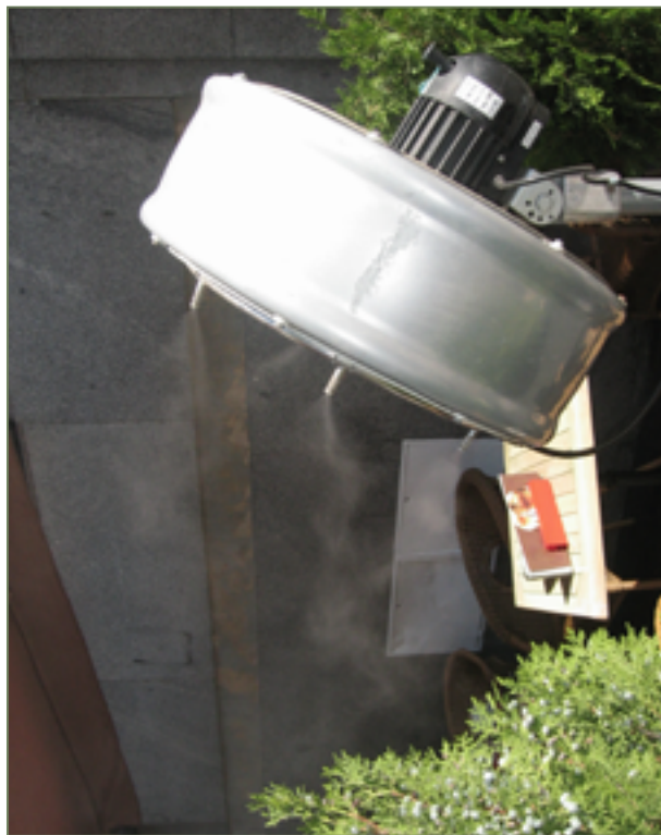
Ventilatore con dispositivo di umidificazione dell'aria
