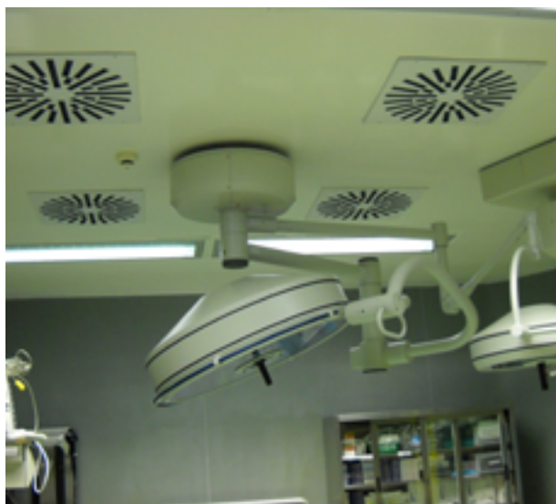
Diffusori a flusso elicoidale in sala operatoria
